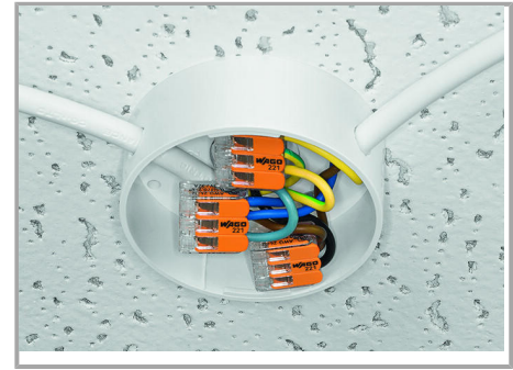
Leuchtenverteilung in Deckenbaldachin
